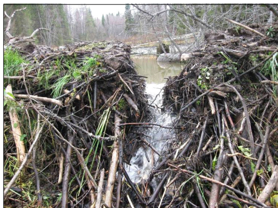
Рис. 4. Проран в теле плотины № 6 (вид со стороны нижнего бьефа)
